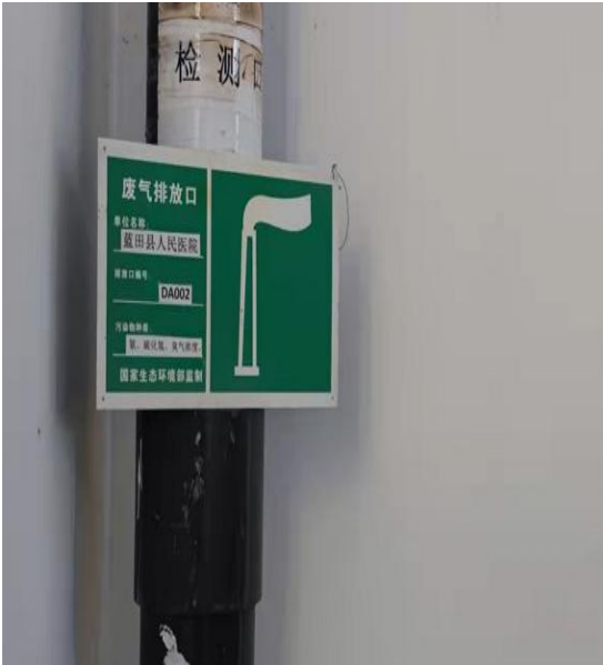
图 5-1.2 污水处理站废气标识牌
