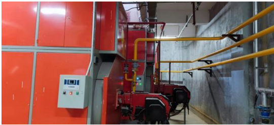
图 5-1.3 低氮燃烧锅炉
