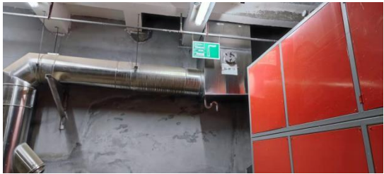
图 5-1.4 锅炉废气标识牌
