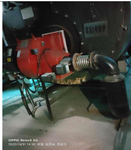
图3.8 燃烧器基础减振
