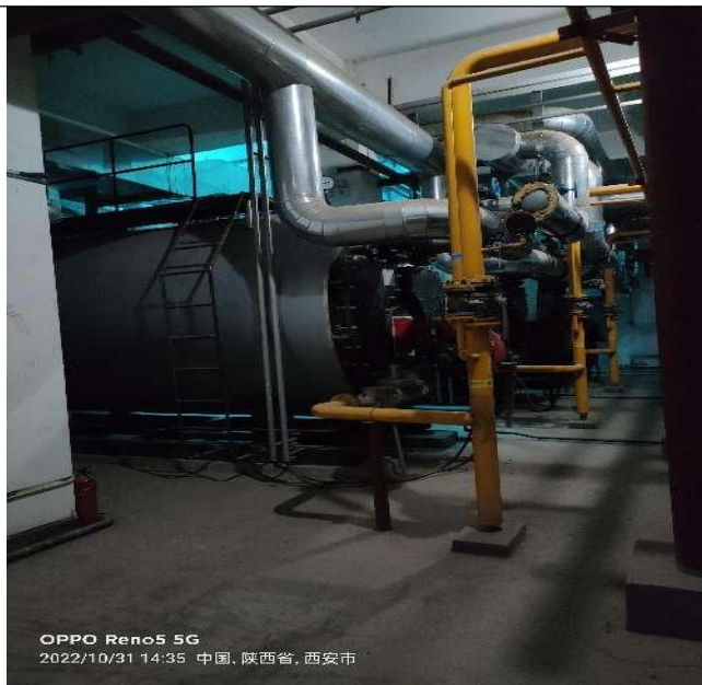
图3.7 锅炉基础减振
